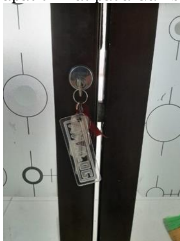
Gambar 1. Sistem Penguncian Pintu Gedung Elektro Politeknik Negeri Bengkalis
