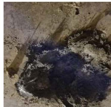
Gambar 15 Honeycomb pada Secant Pile
