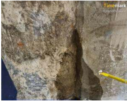
Gambar 4 Leakage pada Secant Pile
