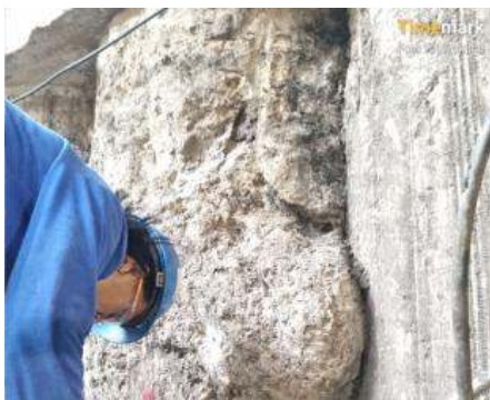
Gambar 11 Bulging pada Secant Pile
