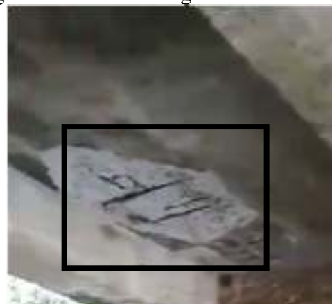
Gambar 4 Selimut Beton Slab Sudah Mulai Terkelupas
