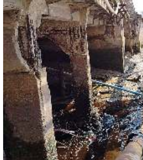
Gambar 6 Pilar Mengalami Retakan yang Parah
