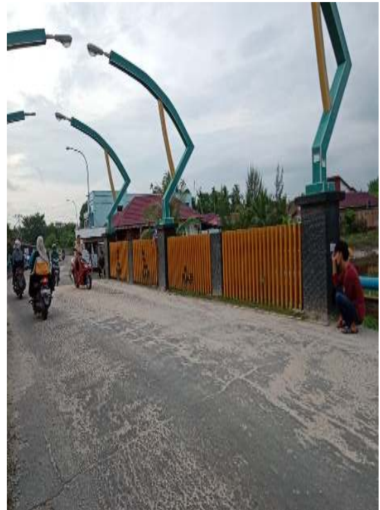
Gambar 1 Kondisi pada struktur lapisan atas jembatan
