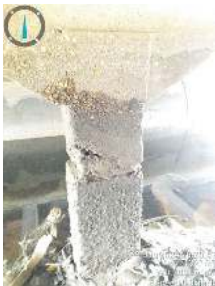
Gambar 4 Kondisi pada pilar jembatan Sumber : (Dokumentasi Skripsi 2024)
